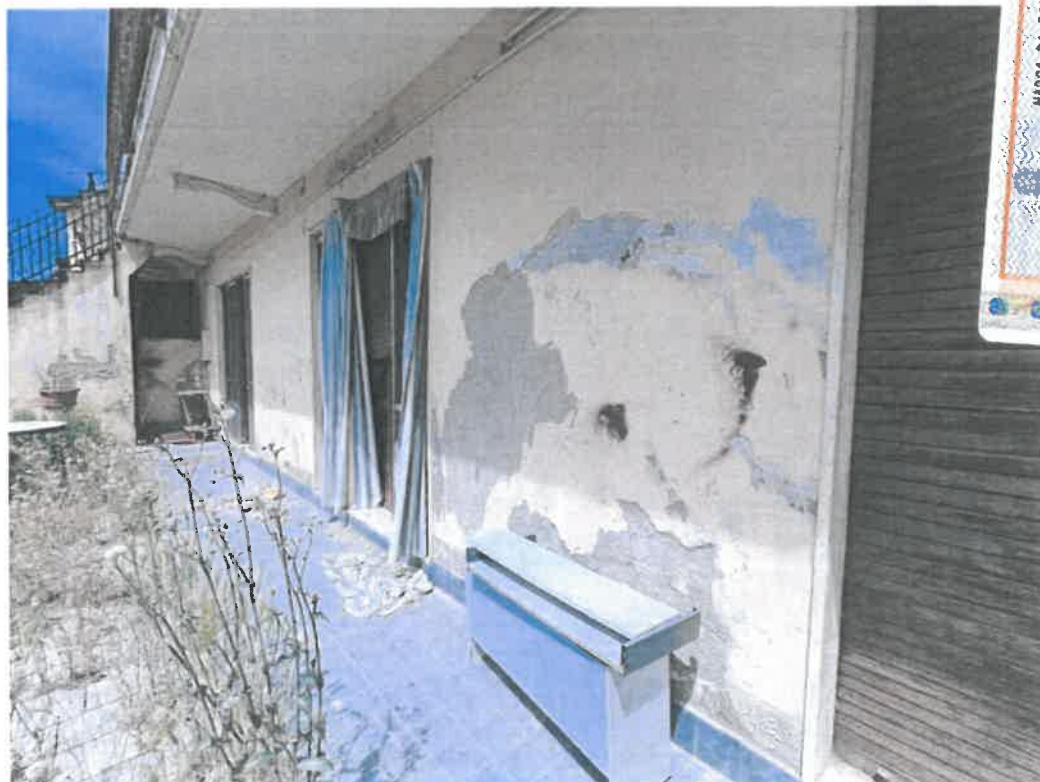
FOTO 10 – VISTA DELLA PARETE ESTERNA LATO SUD DEL PIANO TERRA (TRACCE DI UMIDITA' DI RISALITA')
